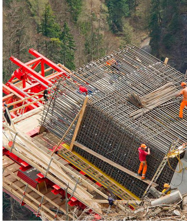
Valens: Bewehrung Grund- detappe Bogen; links: Rendering, © LAP rechts: © Foto: Tiefbau- amt Kanton St. Gallen
